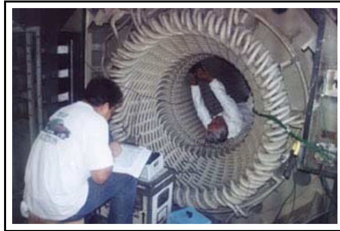
Figura 1.5 Prueba con el equipo “EL CID” a un núcleo de estator.
